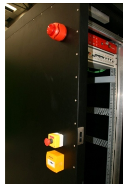
Alarma Pulsador manual de Extinción
