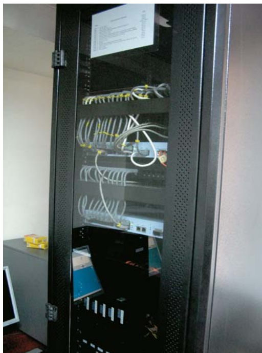
El estándar TIA 942 y la categorización de tiers en Latinoamérica lleva al replanteamiento de las necesidades de infraestructura para la instalación de un datacenter.
